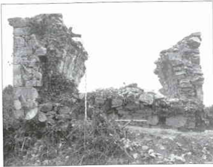
Lám. V, 1. Vista de la cabecera desde el exterior, por el Este, con los arranques de la bóveda de cañón.
